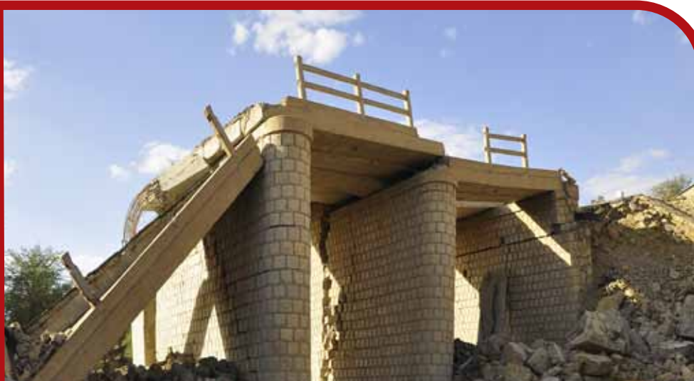
جسر حواري - عمران - الرابط بين محافظتي عمران وصعدة والذي تعرض للقصف عدة مرات أولها تاريخ ١/٥/٢٠١٥م
