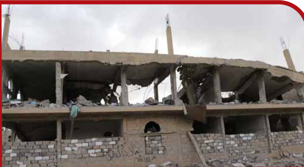
مبنى نقابة المهن التعليمية - عمران - بتاريخ ١٨/٨/٢٠١٥، ونتج عن قصفها قتل (٤) أطفال و(١٧) تريبويًا؛ وجرح طفل وامرأتان و(١٨) مدنيًا.
