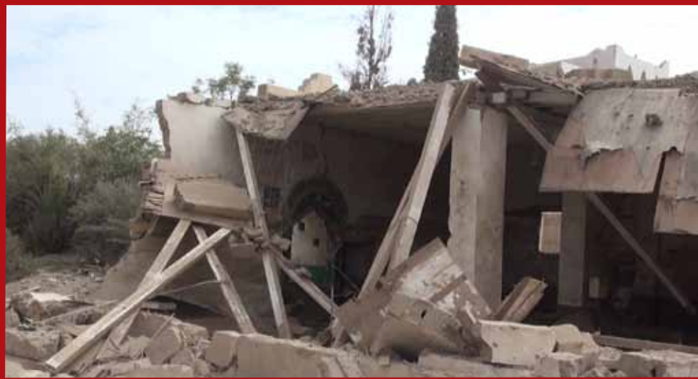
مسجد عطيفة - رازح - صعدة - قصف بتاريخ ٢٠١٥/٥/٧م
